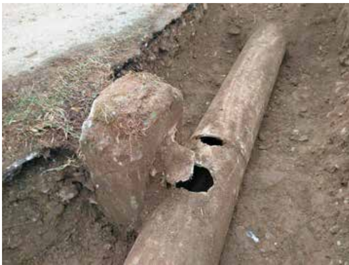
Entwässerungsleitung und Domschacht
