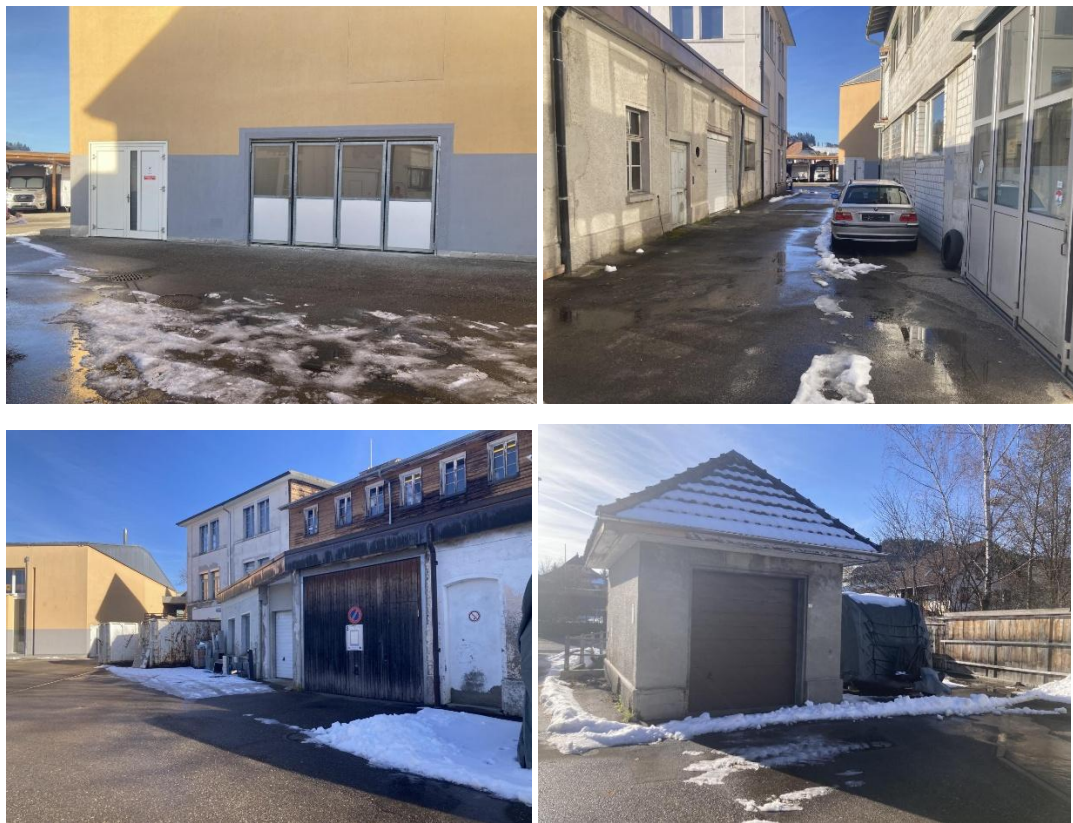
Abbildung 12: Gefährdete Bauteile / Fassadenöffnungen in der gelben Zone (SMAG-Halle oben links) und in der blauen Zone (Liegenschaften Rohrstrasse 15, 19 oben rechts, Liegenschaft Rohrstrasse 15 unten links und Liegenschaft Rohrstrasse 9 unten rechts). Empfohlene Massnahmen: Einbau wasserdichte Türen / Tore. HQ300 Abflusstiefe < 0.5m.
